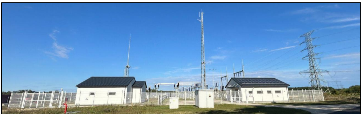
1. kép: 50 MW teljesítményű villamos alállomás jellemző vizuális megjelenése (Csabrendek külterületén 2025)
